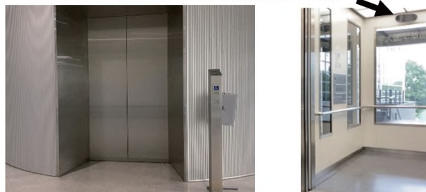
図1 エレベーター（左：外観、右：内部）
